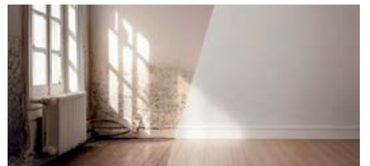
Beschädigtes Mauerwerk vor und nach der Bearbeitung.
