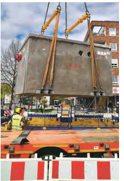
Die Koppelstation wiegt rund 51 Tonnen und ist die erste ihrer Art in Augsburg. Sie ermöglicht die Versorgung mit Wärme aus erneuerbaren Quellen für bis zu 1.500 Haushalte im Wolframviertel.
