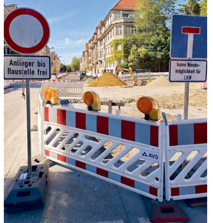
Stadtwerke und Stadt Augsburg bauen in der Rosenaustraße neue Straßenbahngleise, Leitungen und Rohre. Anwohnerinnen und Anwohner haben vorab umfangreiche Informationen über eine Infoveranstaltung, Briefkasteneinwürfe und persönliche Gespräche erhalten.
